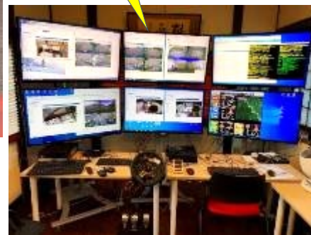
遠隔監視・操作室
