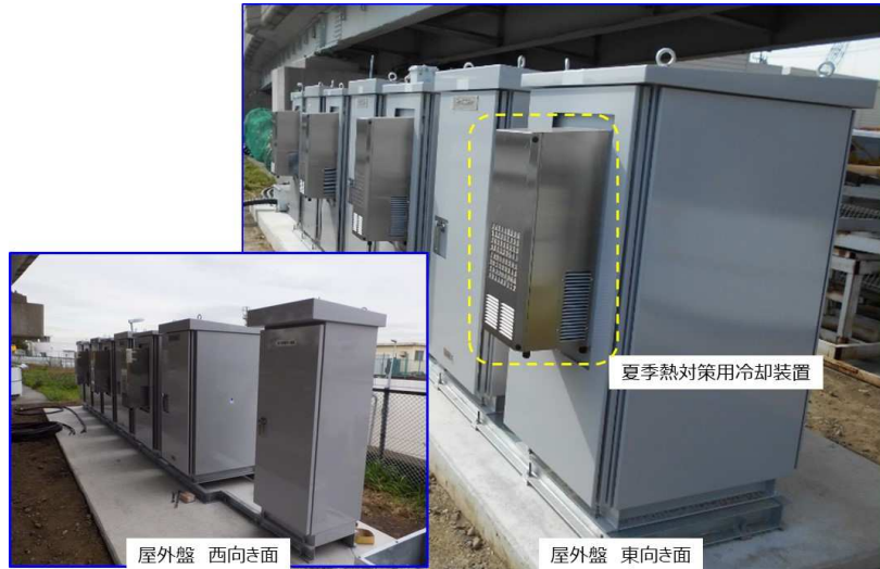
図 3. 5. ETC ゲート通過支援情報提供管理サーバ及び、 センサメーカー各社の路側処理装置を格納した屋外盤外観
