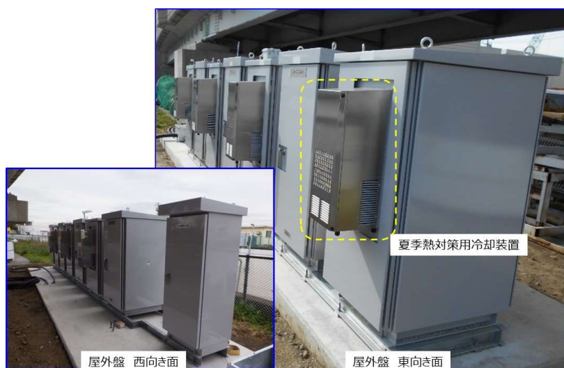
図 4.5-1 ゲート通過支援情報提供管理サーバ及び、センサメーカー各社の路側処理装置を格納した屋外盤外観
