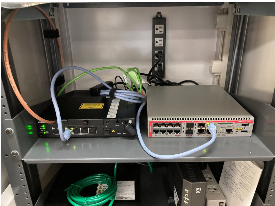
図 7. 2 奈良県警に設置後の ONU とルーター（ラックのトレイ上に設置）
