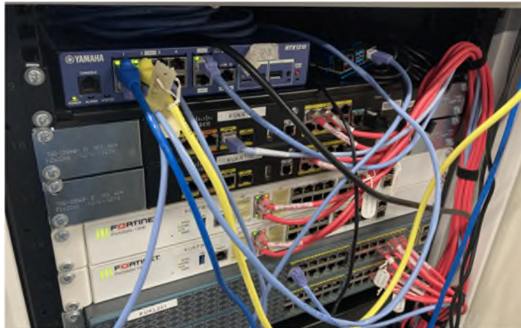
図 4.5 交通管制センターのMVNO 設備
