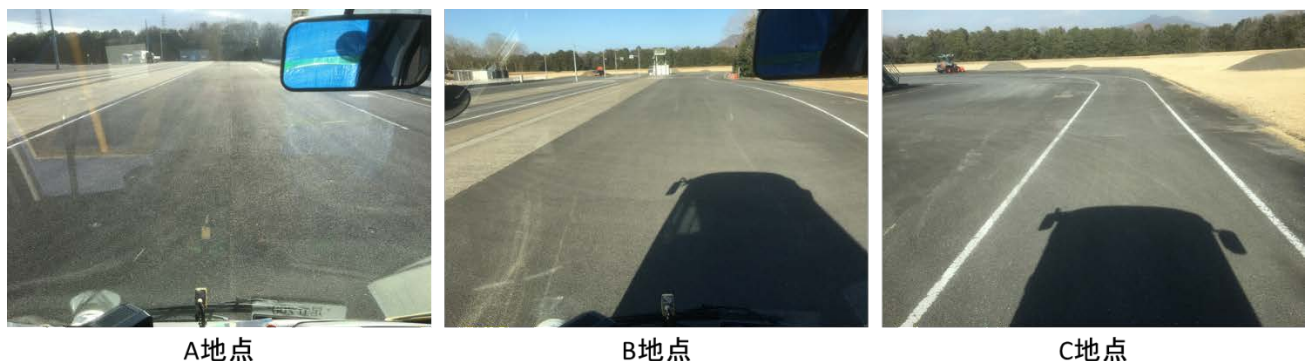
図 1-5.2-1 測定場所の路面状況
